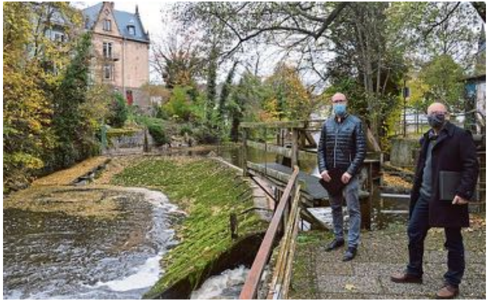
Das Wehr wird von Hubert Verbeek (r.) saniert. Zudem wird eine neue Fischtrappe gebaut. Bürgermeister Ingo Pfenning ist begeistert.
